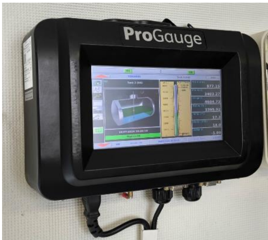
Att. 25. Degvielas mērsistēma ProGauge Limbažu lidlaukā
